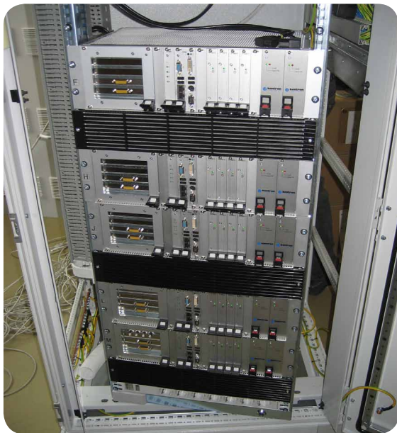
Bild 1: Die VDEC-Einheiten in der Leitwarte.
