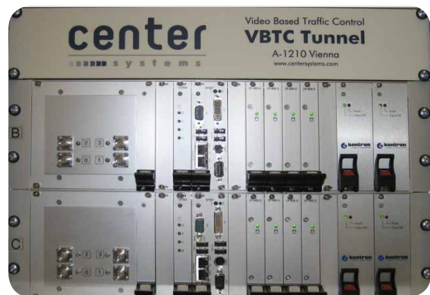
Bild 4: Der Systemaufbau der VBTC Tunnel VESA-Einheiten von links nach rechts: PCI basierte Framegrabber-Karten, RAID-Controller, Kontron CP-307 CPU-Board, vier Festplatteneinschübe sowie zwei Netzteile.
