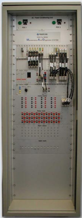
Abb. 3. Das Instandhaltungs- und Diagnosesystem ermöglicht es den Betreibern, die Funktionalität aller SDS 2 Bauelemente zu überprüfen.
